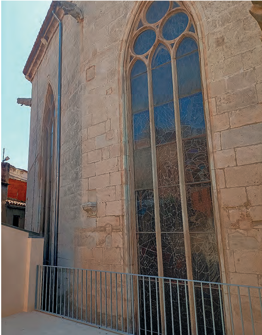
Las vidrieras han sido objeto de rehabilitación.
